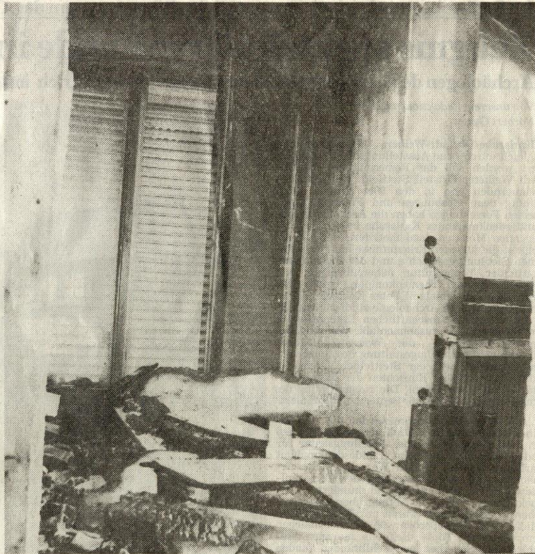
VÖLLIG AUSGEBRANNT ist der Dachstuhl eines Wohnhauses in Oberderdingen. Die Kripo geht von Brandstiftung aus. Foto: Kampf
